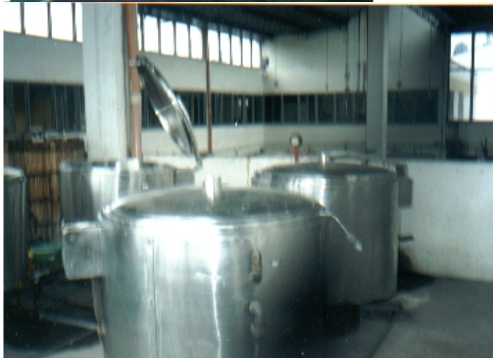
Figura 1. Cubas de fermentación ubicadas en el Laboratorio de Ingeniería Química
