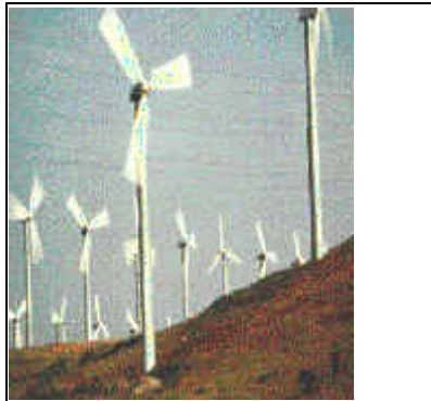
Campo de generadores eólicos
