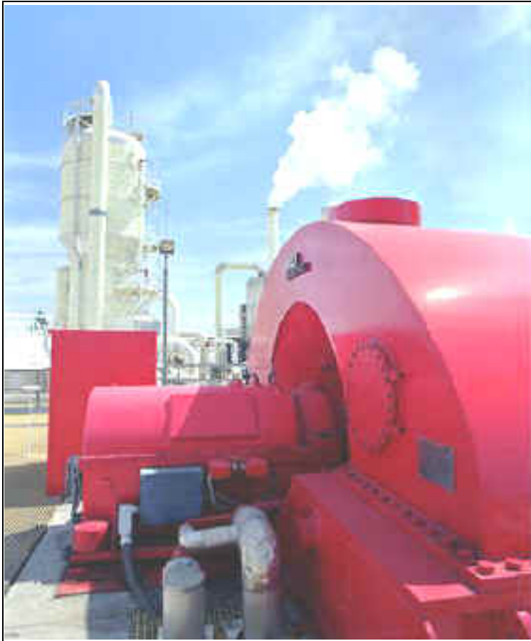
Central geotérmica de Brawley, California
